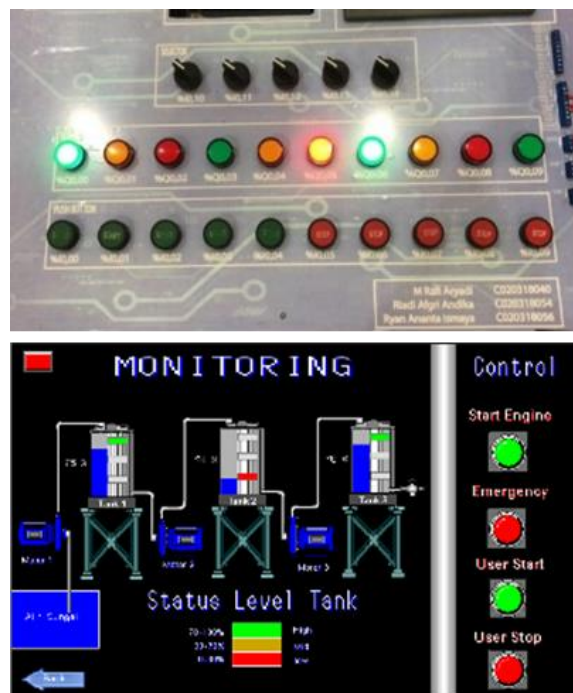
Gambar 15. Visual Kondisi 3 pada tank 1 dan 3
