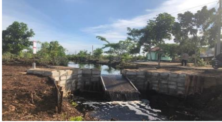
Gambar 2. Sekat kanal beton (Sutikno et al. 2019)
