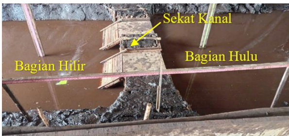
Gambar 11. Keadaan saat dilakukan pengujian rembesan (Sumber: Hasil dokumentasi lapangan)
