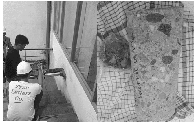
Gambar 10. Core Drill test Gedung Plasa Telkom Padang Sidempuan
