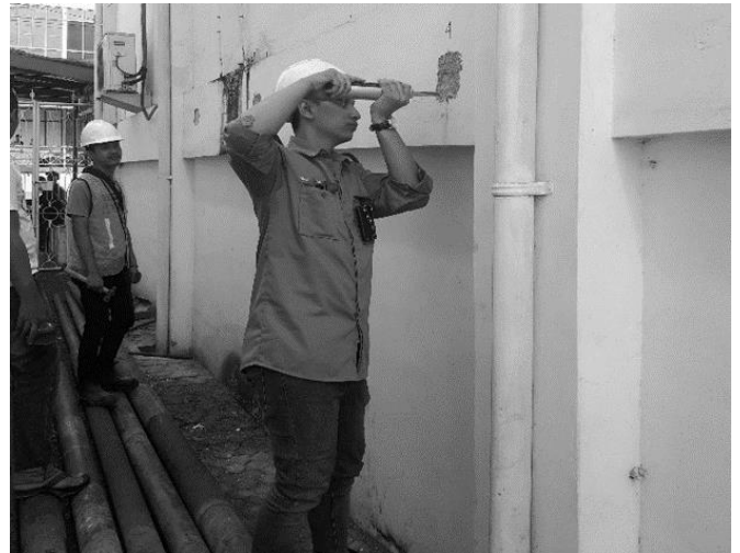
Gambar 7. Identifikasi kegagalan pelat lantai
