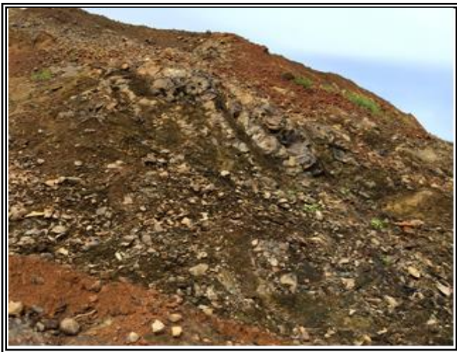
Gambar 3. Kondisi batuan di area Maindam kiri bagian permukaan sebelum dilakukan proses penggalian.
