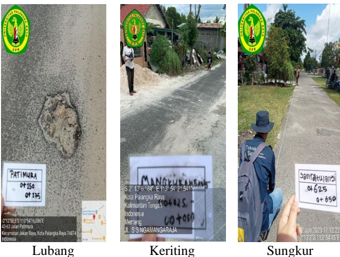
Gambar 5. Jenis Kerusakan Pada Ruas Jalan di Kawasan Tunjung Nyaho
